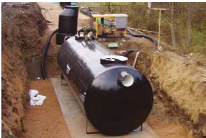
Separatori di coalescenza con vasca di sedimentazione SKG 150 - Piesok, Polonia
