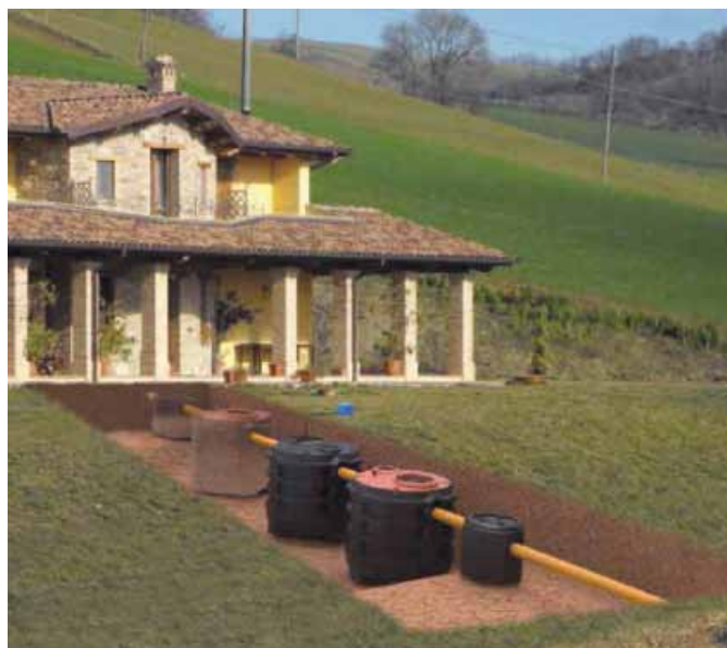
Trattamento biologico SECONDARIO
